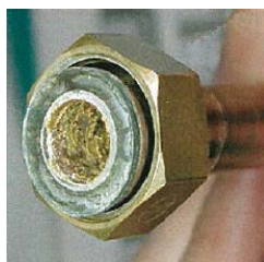
配管に詰まったスケール
